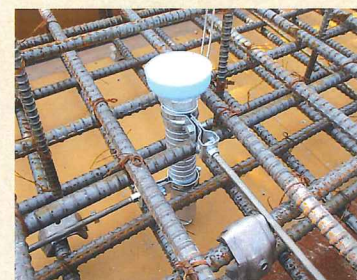
鋳心管(排水パイプ)
